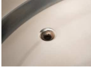
Sistema de desagüe en el interior
