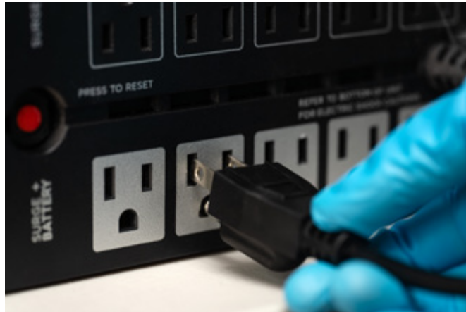
Figura 5. Energizar Mini Cabina
